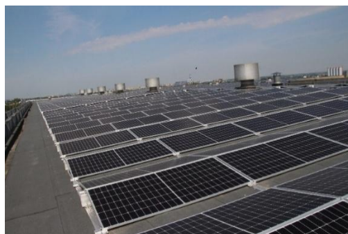
Fot. 13 Elektrownia fotowoltaiczna o mocy 1,1 MW (Lublin)
