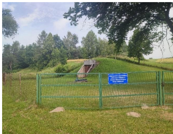
Rys. 60 Hydrofornia w miejscowości Kawęczyniek wymagająca remontu źródło: wywiad terenowy (lipiec 2025r.)
