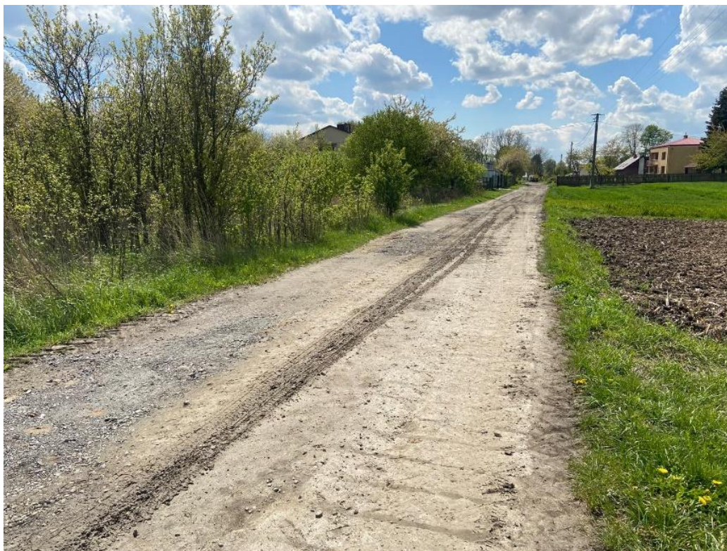
Rys. 61 Droga w stanie złym w miejscowości Rzeczycza Ziemiańska Źródło: Wywiad terenowy
