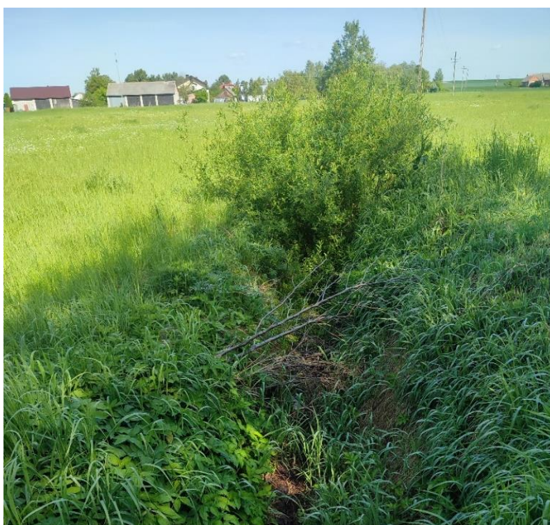
Zdjęcie 28 Rów melioracyjny wymagający renowacji, źródło: własne, inwentaryzacja terenowa (maj 2024 r.)
