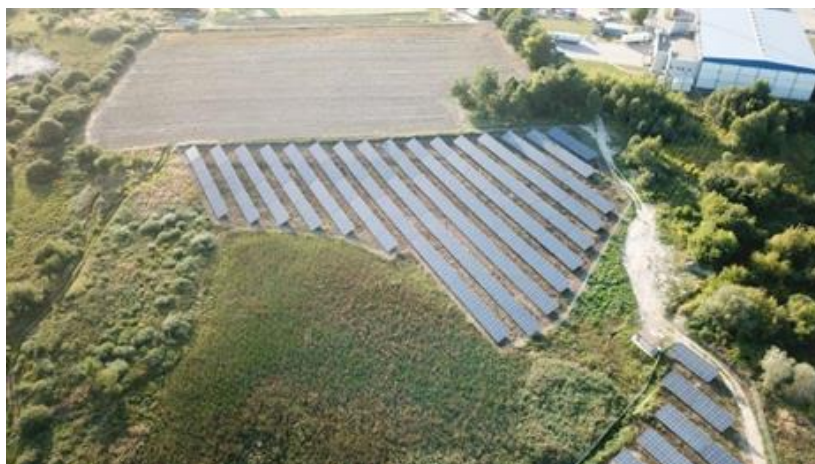
Fot. 50 Farma fotowoltaiczna o mocy 950 kW na terenie gminy Tomaszów Lubelski
